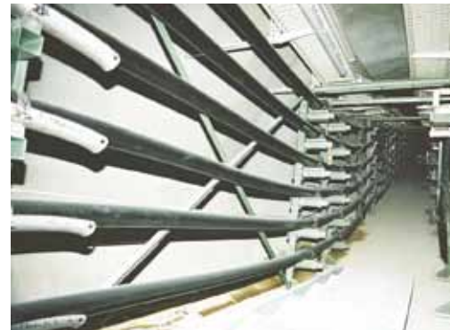
Tunel kablowy / Cable tunnel
